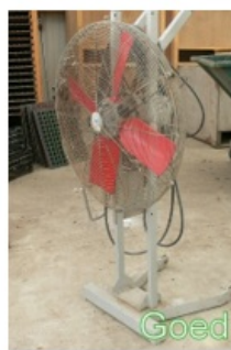
Goed afgeschermd ventilator
