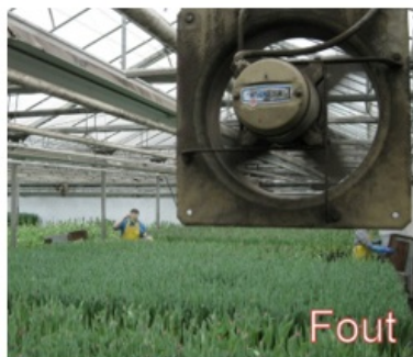
Onafgeschermd ventilator, laag geplaatst
